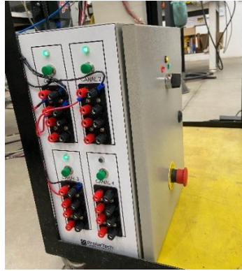
Figura 5 – Sistema de alimentação elétrica da bancada de testes.
